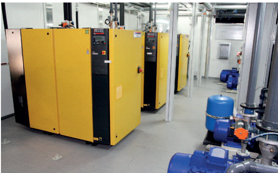
Energieoptimierte, wassergekühlte Druckluft-Kompressoren mit Wärmeaustauschern zur Nutzung der Abwärme für Heizzwecke
