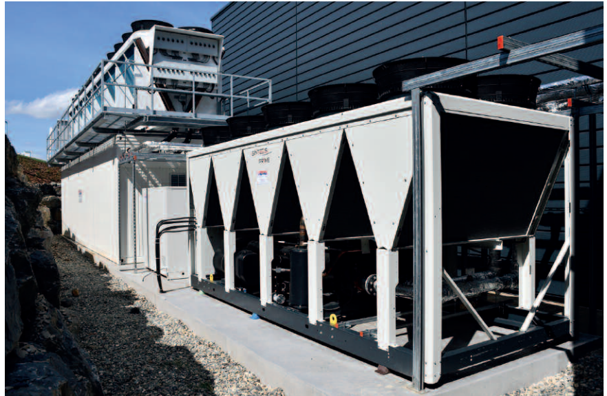
Energieoptimierte Container-Kühlanlage mit Kältemaschine und leerlaufendem V-Freikühler zur stromsparenden Winterentlastung der Kältemaschine
