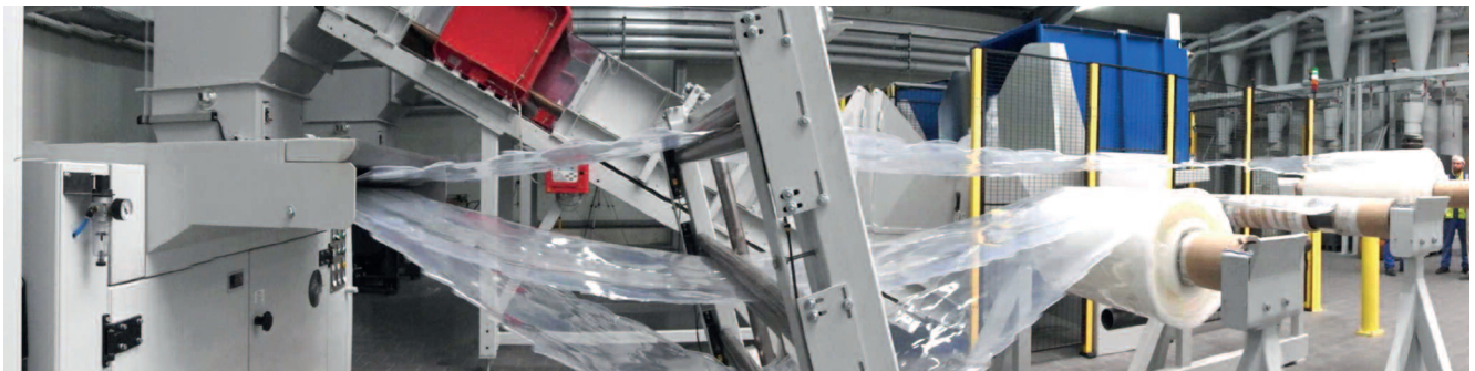
Den Mittelpunkt der dritten Zerkleinerungslinie im Aufbereitungszentrum von Pro-Pac bildet eine Einzugs-mühle von Getecha (Typ RS 3012 E), die synchron PP-Folienreste unterschiedlicher Dicken zerkleinert. Die Zuführung erfolgt über eine dreiteilige, sensorgesteuerte Abrollvorrichtung
