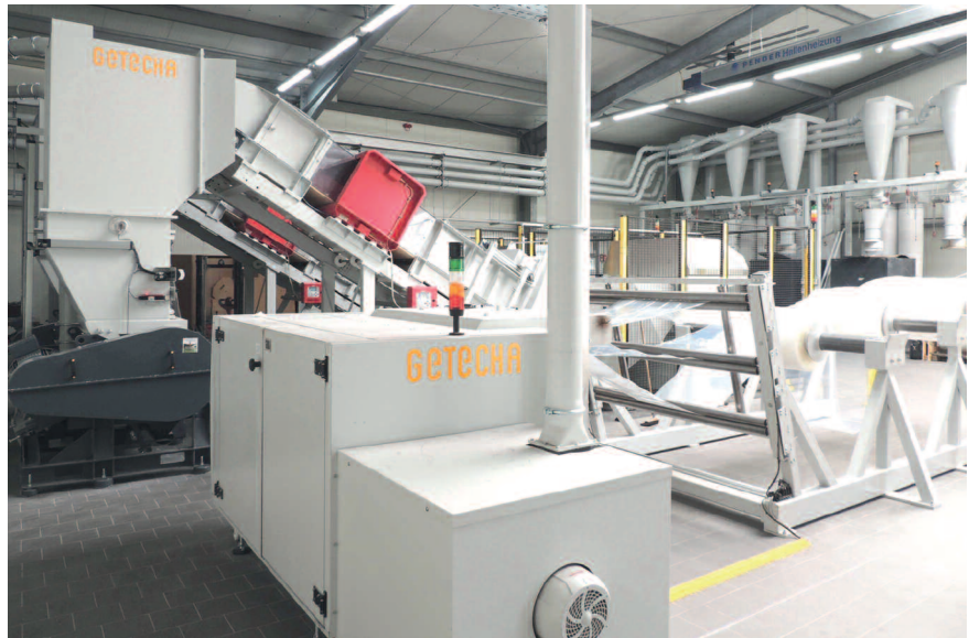
Im neuen Zerkleinerungszentrum von Pro-Pac sind alle Getecha-Zerkleinerungslinien an eine Saug-Druck-Förderanlage mit Mahlgut- und Abluft-Entstaubung. Die Abluft wird über Zyklone (Bildhintergrund) abgeschieden und nach der Reinigung über Abluftfilter an die Umgebung abgegeben
