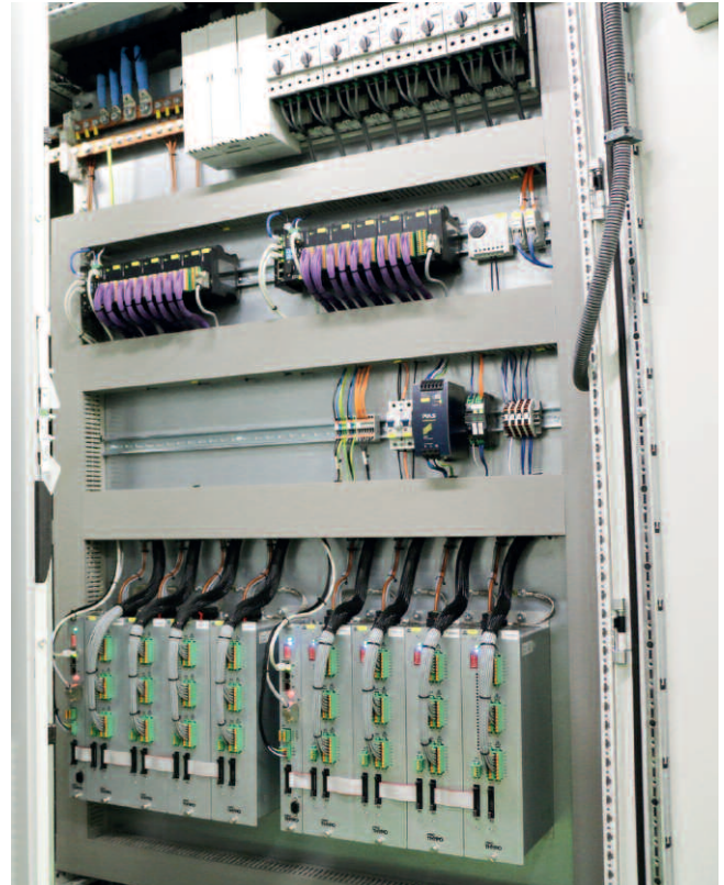
Schaltschrank nach der Modernisierung durch MC Control
