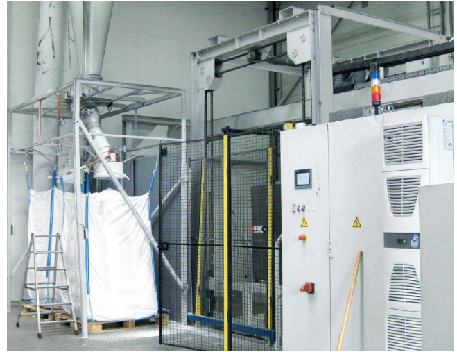
Dreistufige Aufbereitung: Die für Infinex realisierte Komplettlösung von Getecha erstreckt sich von der Zuführtechnik mit Hebe- und Fördersystemen über die Zerkleinerung mit einer Zentralmühle vom Typ RotoSchneider RS 6015 bis hin zur Förderung des Mahlguts zu einer Doppel-BigBag-Station (links). Gesteuert wird der gesamte Prozess von einer Siemens SPS S7 (rechts) (Bild: Stöcker)
