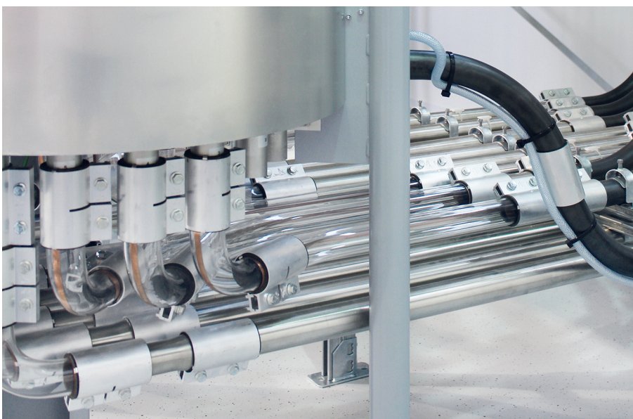
Speziell für abrasives Fördergut sind die Leitungen und Bögen aus Borosilikatglas (links), Edelstahl (unten) oder speziell gehärtetem Edelstahl (rechts, schwarz) ausgeführt. Im Bild eine Musteranlage im Motan-Colortronic-Technikum (Alle Bilder: Motan-Colortronic)
