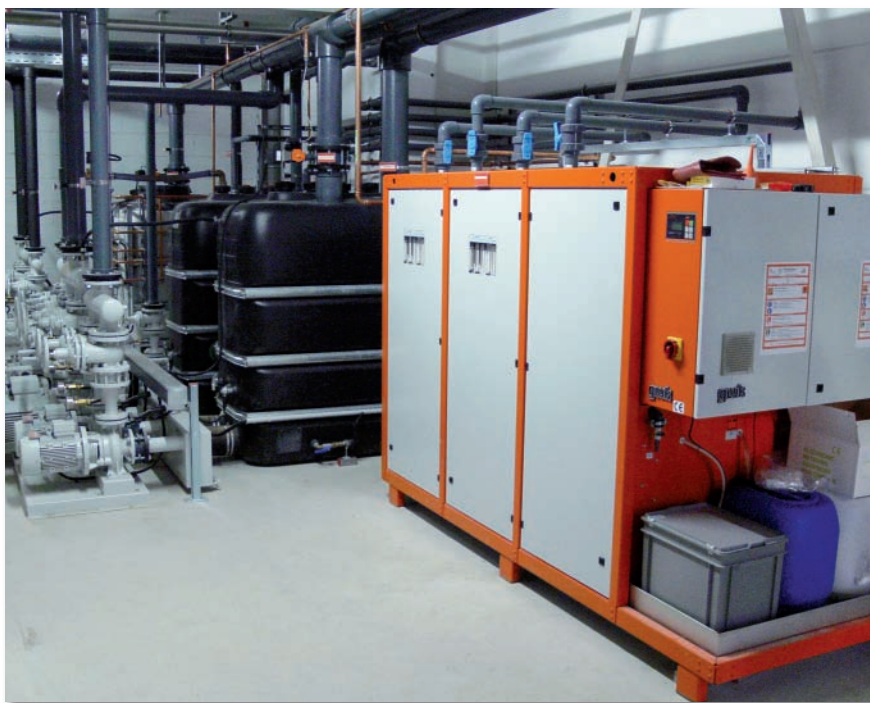
Das Kühlanlagenkonzept bei der Polifilm GmbH umfasst eine individuell angepasste Konfiguration mit drei Rückkühlanlagen mit einer Gesamtkühlleistung von 2.800 kW bei einer Kaltwassertemperatur von 10 °C bzw. 12 °C (Quelle: gwK)
